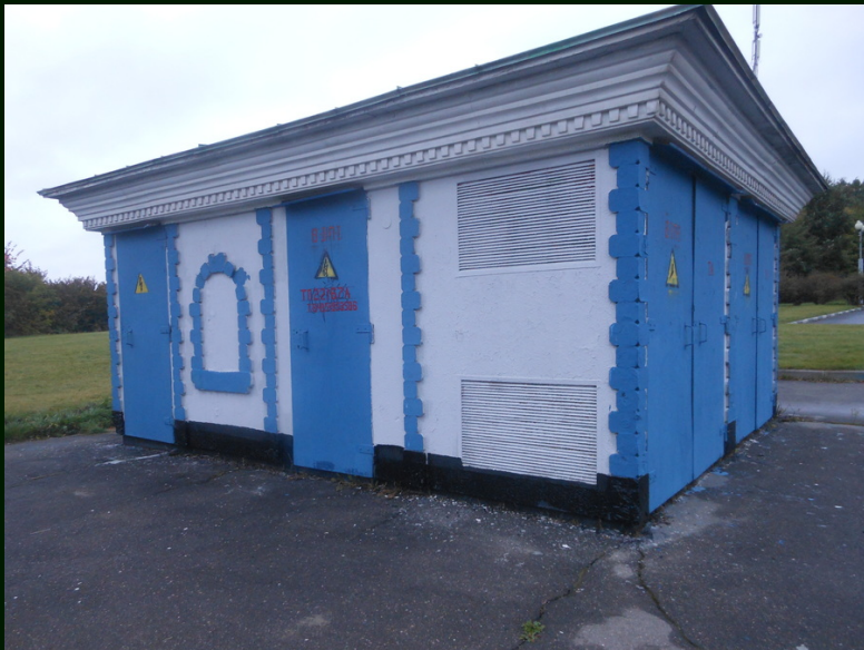
2020-09-19-9865 – Трансформаторная подстанция. Радуют ордерный карниз с дентикулами, оконный наличник, руст, бассажаж и цоколь
