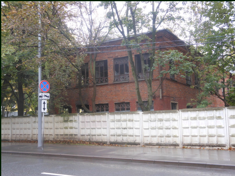
2020-09-19-9957 – Видны следы пожара
